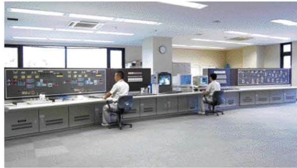
● 中央監視室で全施設の運転状況を監視
