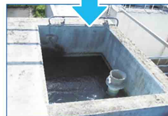
着水井 ダムから来た水を溜めています。
