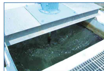
混和池 小さなゴミを沈みやすくする薬品を入れよくかき混ぜます。
