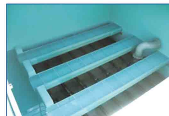
ろ過池 沈殿池できれいにした水を砂の層でこします。
