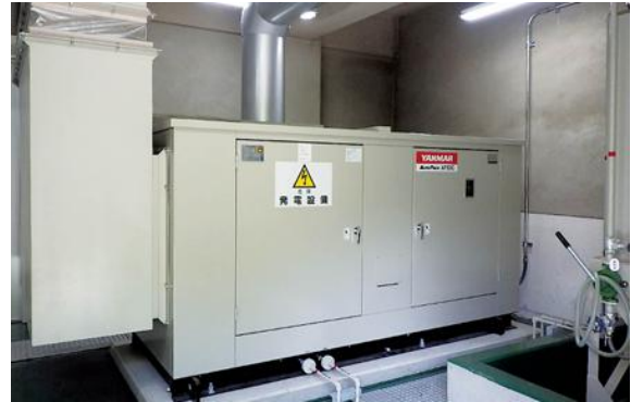
～自家用発電機（上田浄水場）～
