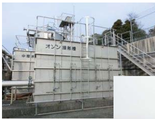
オゾン処理槽
