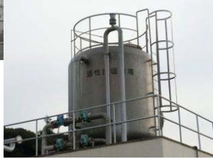
活性炭吸着槽
