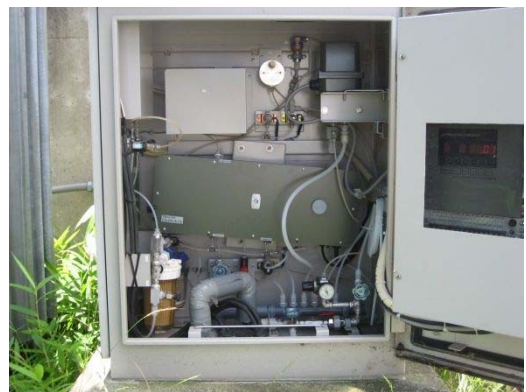
自動監視装置の写真
