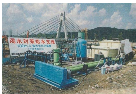
渇水対策用の海水淡水化設備 （平成6年・洲本市）
